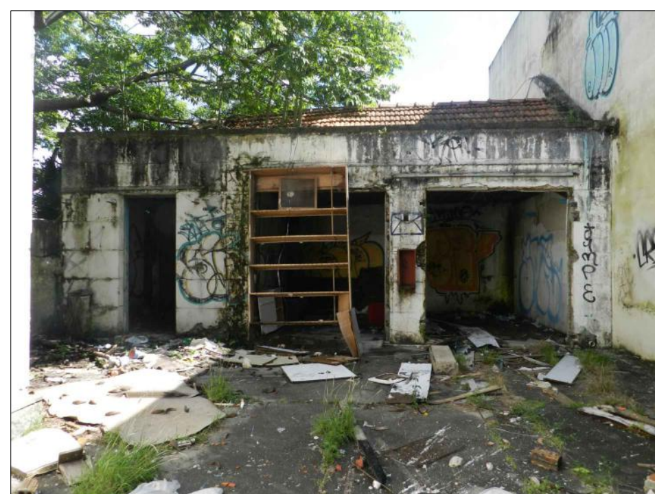
VISTA FRONTAL DA GARAGEM, EM ARRUINAMENTO
