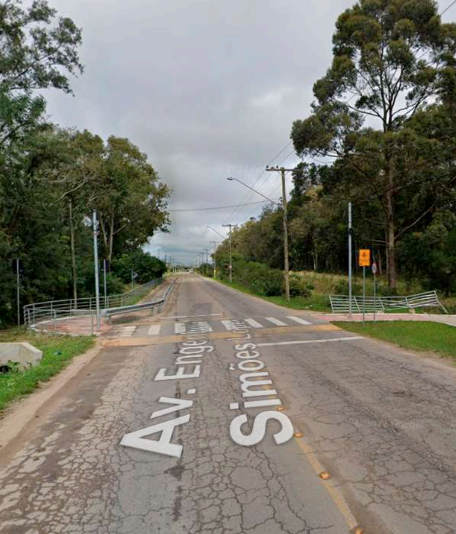
Figura 2.25 - Trecho novo da ciclovia da Avenida Ildefonso Simões Lopes, continuado em 2021 e já com parte do guarda-corpo danificado. Fonte: Google Earth, 2022.
