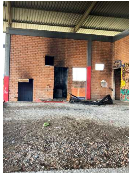
Figura 05.2.2: depredação da área destinada às oficinas - interior fonte: autora, 2022.
