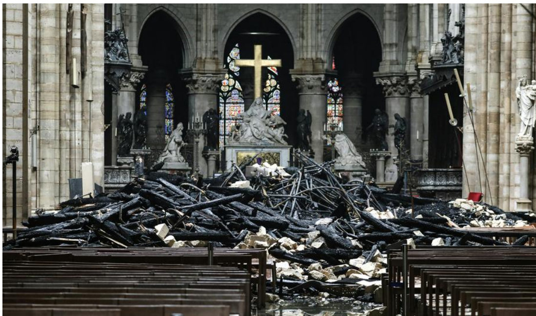
Figura 17 - Catedral de Notre-Dame em Paris severamente afetada após incêndio. Fonte: Divulgação Jornal Zero Hora. Foto: Ludovic Marin / AFP.
