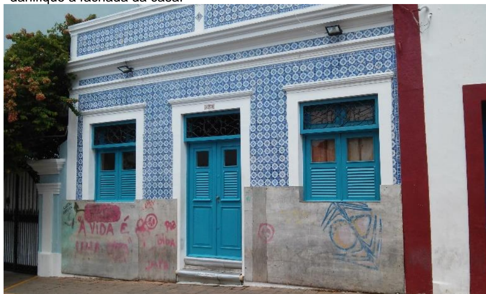
Figura 54 - Casa residencial com tapumes para prevenir que a urina dos foliões danifique a fachada da casa.
