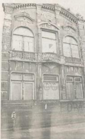
Teto do prédio histórico desabou em 2014
