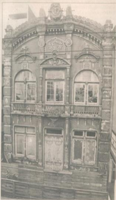
Datado de 1912, prédio situado na rua Marechal Floriano encontra-se em ruínas
