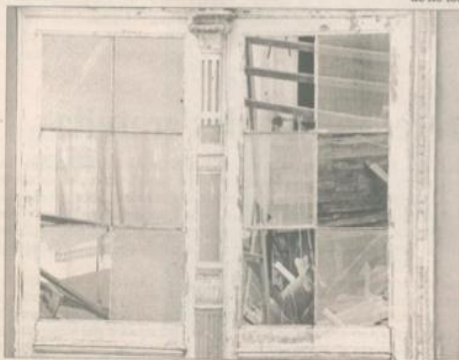
Segundo piso está escorado, para evitar novo desmoronamento
