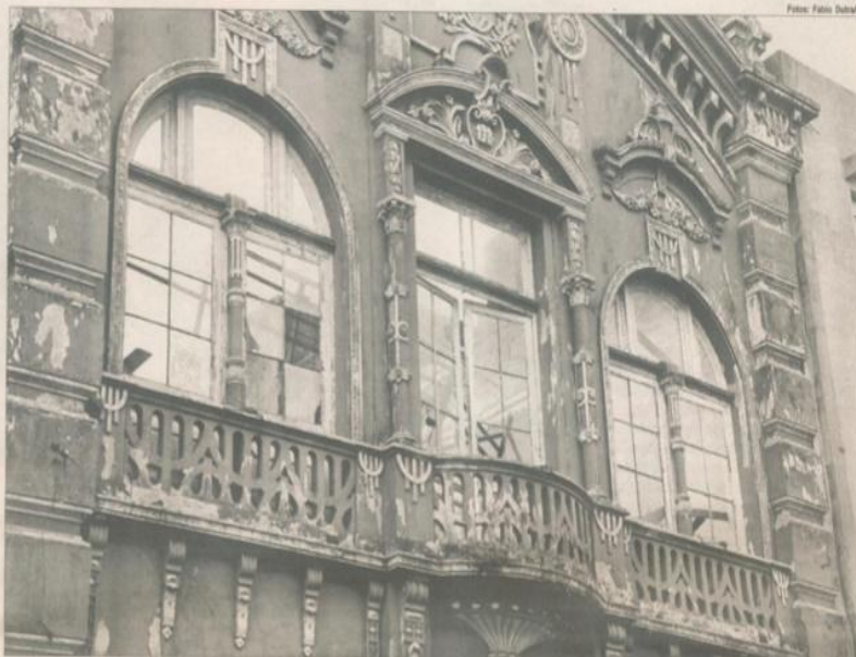
Teto desabou em março de 2014
