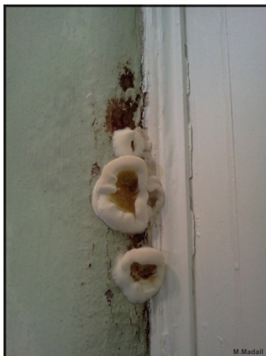
Figura 73: Fungo gerado por goteiras.
