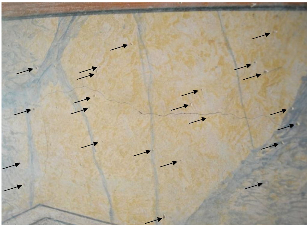
Figura 15 – Escaiola com fissura horizontal e vesículas espalhadas por toda a superfície.
