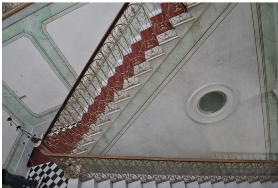
Figura 2 – Escadaria do prédio do Paço Municipal, paredes revestidas em escaiola. Praça Coronel Pedro Osório, 101, Pelotas/RS.
