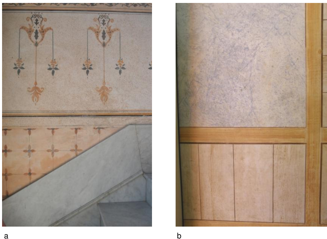
Figura 6 – (a) Detalhe de escaiola com pintura que simula azulejos na escadaria do hall de imóvel comercial localizado na Rua Gonçalves Chaves, 660, Pelotas/RS. (b) Detalhe de escaiola com pintura que simula painéis de madeira e mármore no imóvel pertencente à UFPel, localizado na Rua Félix da Cunha, 570, Pelotas/RS .
