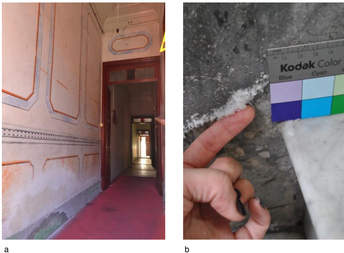
Figura 17 – (a) Eflorescência esbranquiçada na parte inferior da parede. (b) Detalhe de eflorescência esbranquiçada na parede de escadaria.
