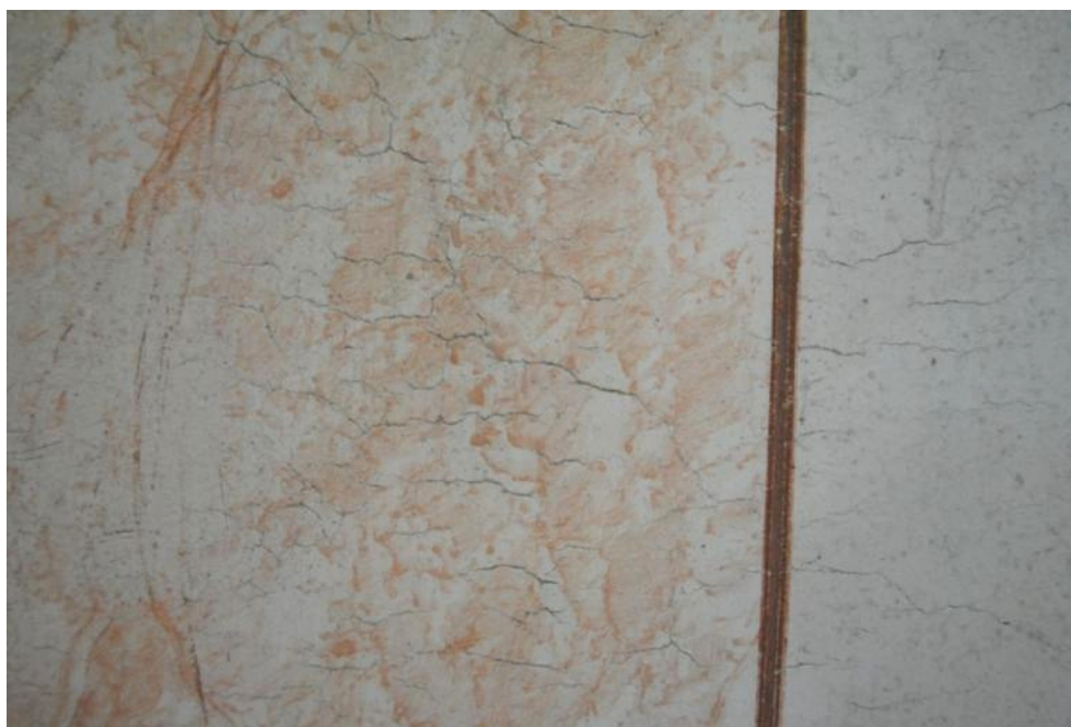
Figura 21 – Fissuras mapeadas na superfície do revestimento de escaiola.
