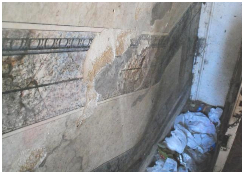
Figura 19 – Abaulamento do revestimento provocado pelo seu descolamento da alvenaria. Hall de entrada de casa localizada na rua XV de Novembro, 563, Pelotas/RS.
