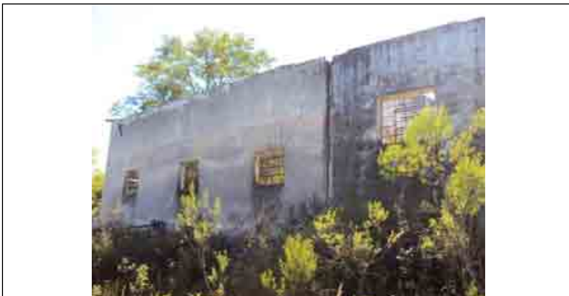
Figura 86- Interrupção visível na fachada entre o prédio mais antigo e a parte construída posteriormente. Fábrica de Conservas Schaun.
