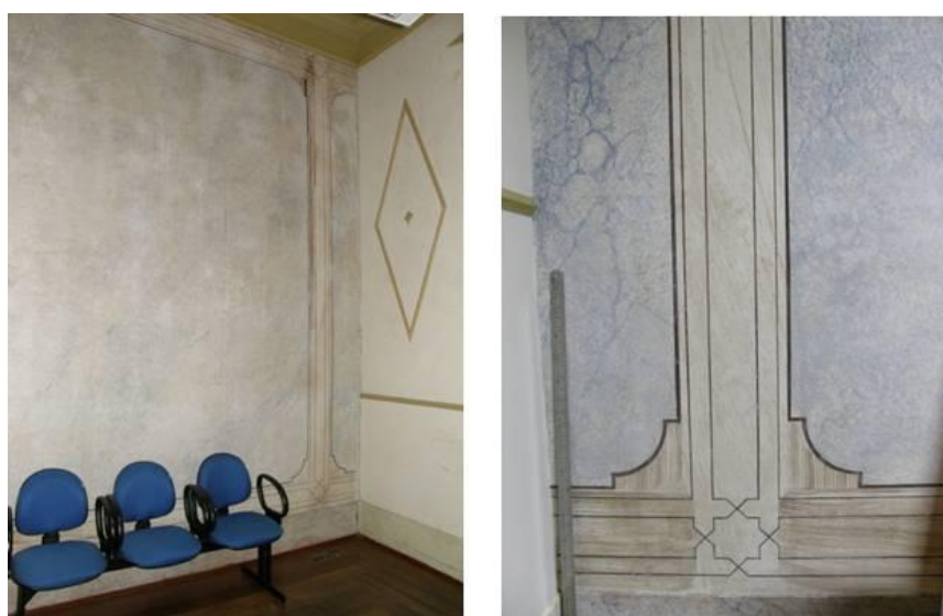
Figura 68: Aspectos das decorações que restaram na antiga sala de jantar da moradia.
