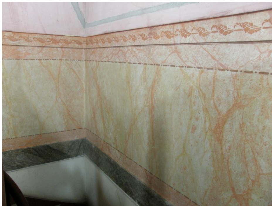
Figura 74: Aspecto da parede escaiolada da cozinha.
