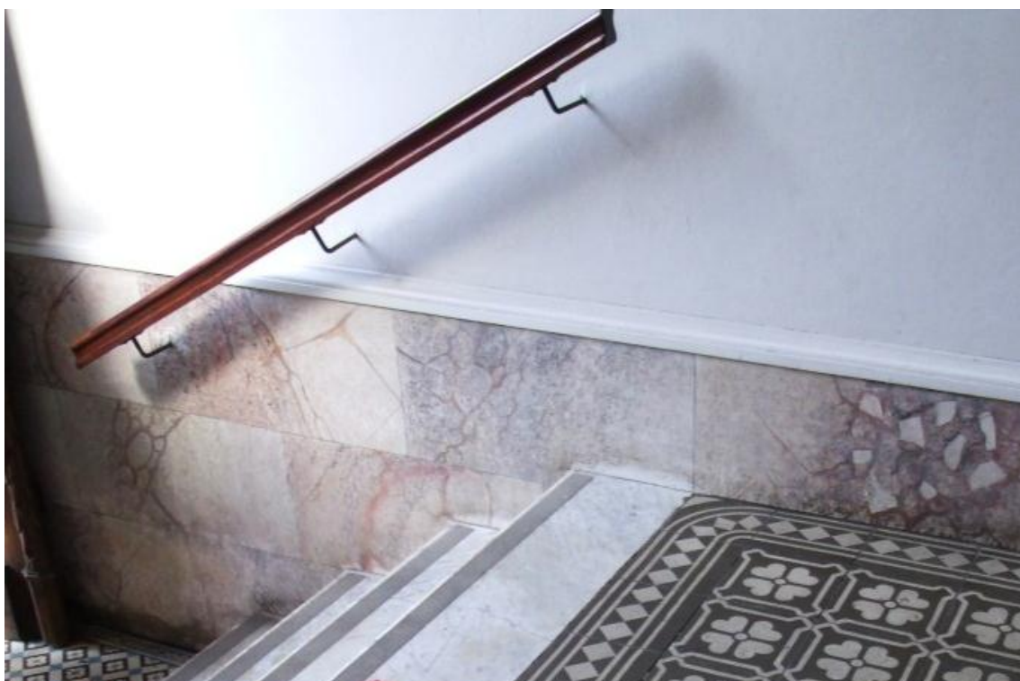
Figura 92: Na imagem, detalhe do arranjo das escaiolas em placas no hall de entrada.
