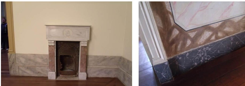
Figura 31: (E) Marmoreado executado no rodapé de uma sala do casarão do Conselheiro Maciel. (D) A mesma técnica no rodapé do hall da escada do sobrado que pertenceu ao Barão de Butuí.
