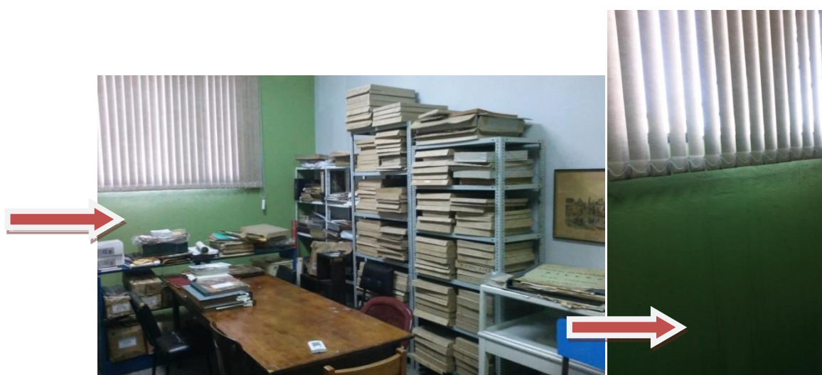
Figura 47 – Manchas de infiltração (sutis) abaixo da janela do Arquivo Histórico. Foto: Taciane Souza, 2015.
