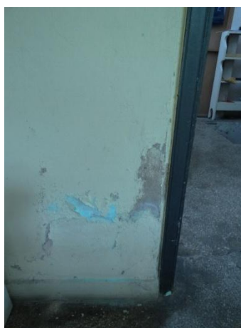
Figura 45 – Desprendimento da camada de tinta no laboratório de conservação no MPR. Foto: Taciane Souza, 2015.
