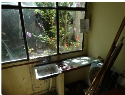
Figura 97 – Instalação hidráulica na mesma área da sala de procedimentos.
