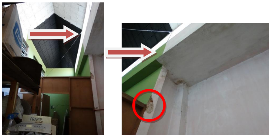
Figura 46 – Infiltração abaixo das janelas (indicadas) e parte faltante do reboco no laboratório de conservação Foto: Taciane Souza, 2015.
