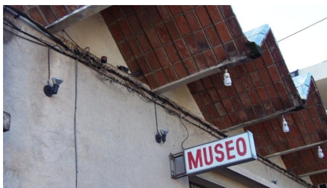
Figura 49 – Fachada do museu: fios elétricos cobertos por excrementos e ninhos de pombos. Foto: Taciane Souza, 2015.
