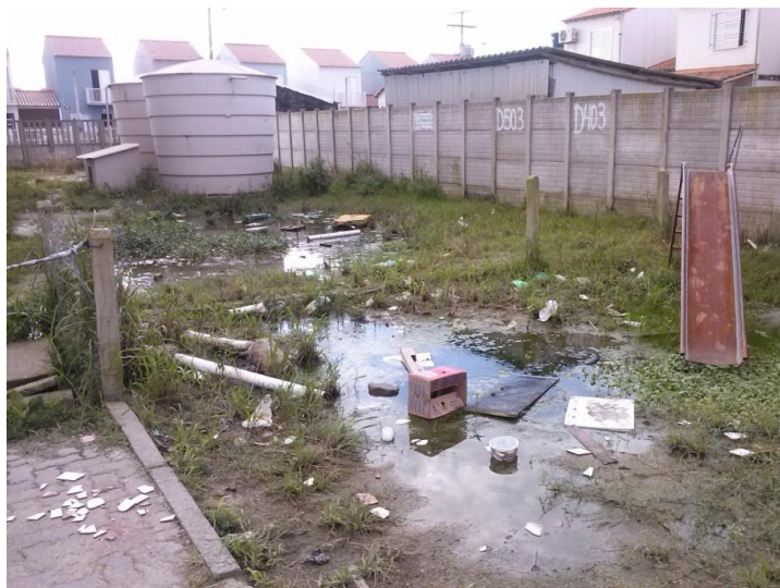
Figura 5: Transbordamento do esgoto em meio à área de recreação infantil Fonte: Autores (2016)
