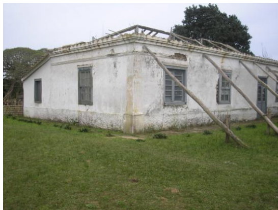
Figura 7: Casarão com danos estruturais, sustentado com escoras de madeira. (Fonte: Arquivo pessoal)
