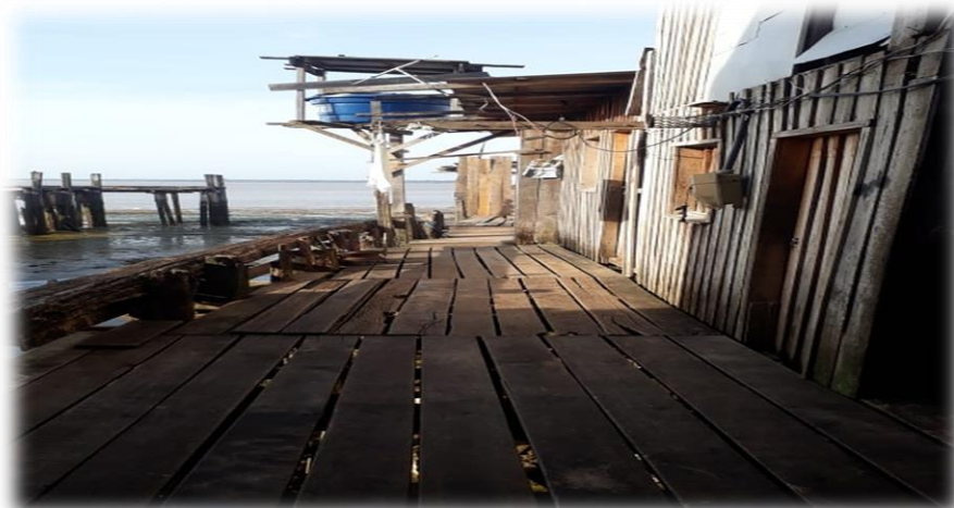
Figura 04 - Fotografia das palafitas da Vila Caripunas, no bairro do Jurunas, fincadas às margens do Rio Guamá
