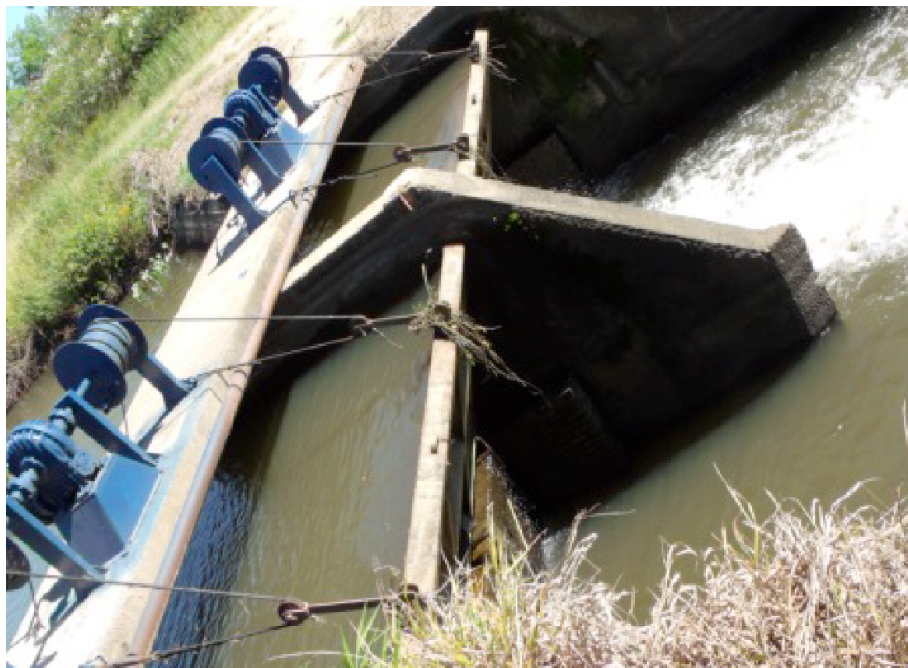
Figura 3 - Elevadora de nível do Perímetro AUD - Duas comportas
