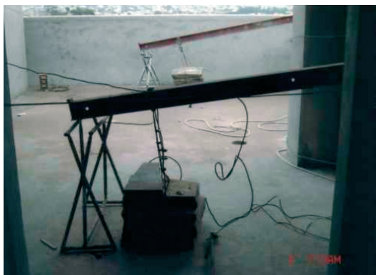
Figura 4: Sistema de contrapeso para sustentação do contraventamento, utilizando pedras amarradas sem marcação de peso
