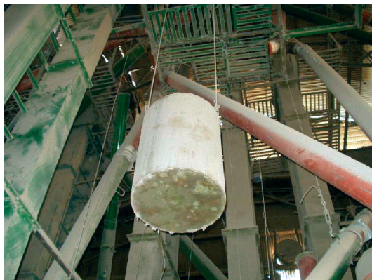
Figura 2: Cabo de sustentação do sistema de contra-peso da fita transportadora não dimensionado e fixo com apenas um “clips”
