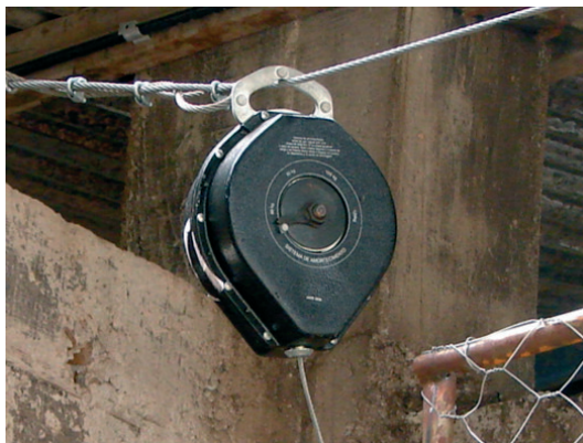
Figura 8: Detalhe do trava-quedas retrátil e cabo de segurança, instalado após a interdição dos setores de carregamento e descarregamento de grãos
