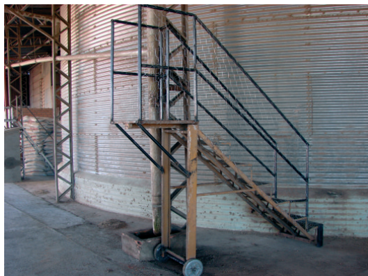
Figura 7: Escada para limpeza dos caminhões dotada, após a sua interdição, de guarda-corpo metálico
