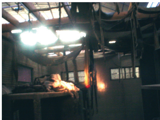
Figura 1: Sala de metalização e aplicação de verniz após a explosão
