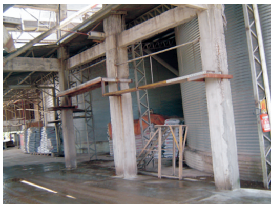
Figura 1: Vista das plataformas, no local onde ocorreu o acidente, visivelmente sem proteções
