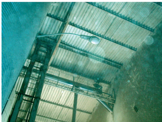
Figura 1: Interior do armazém onde ocorreu o acidente. À esquerda, silo e elevador de grãos
