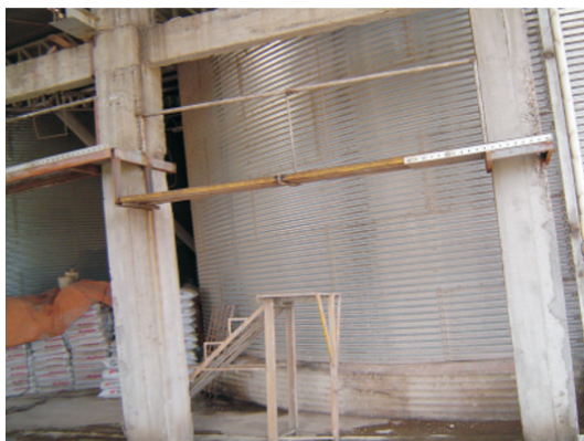
Figura 2: Detalhe de plataforma e escada, no local onde ocorreu o acidente, sem proteção
