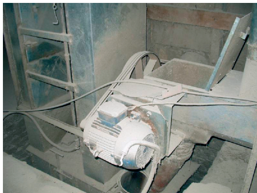
Figura 3: Transmissões de força das máquinas e equipamentos não-enclausuradas
