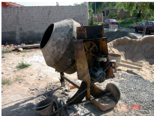
Figura 3: Betoneira envolvida no acidente
