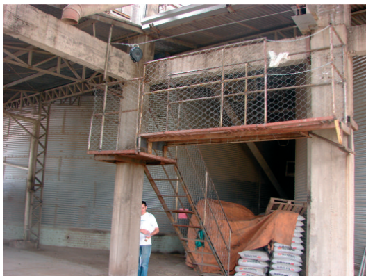
Figura 6: Plataforma no local do acidente adequada, após sua interdição, com guarda-corpo, cabo de segurança e trava-queda retrátil
