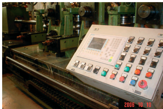
Figura 4: Vista do painel de operação e controle da máquina formadora de tubo, que era operado pelos acidentados durante o processo de manutenção e regulagem
