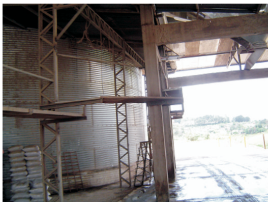
Figura 3: Vista de outro ângulo da plataforma, no local onde ocorreu o acidente, sem proteção
