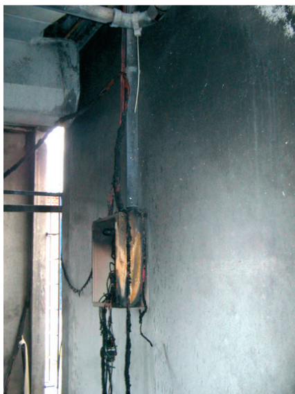
Figura 5: Quadro elétrico interno da sala de extração química
