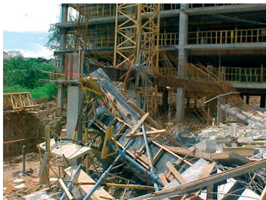
Figura 4: Resultado do desabamento da laje: fôrmas e escoras caídas
