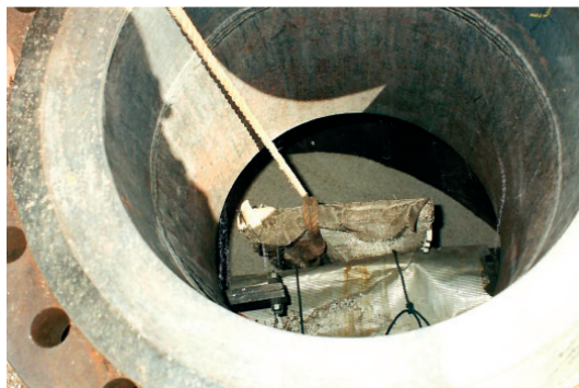
Figura 4: Boca de visita aberta, corda içando a grade e tubo distribuidor do vaso, após o acidente, com a peneira molecular já rebaixada
