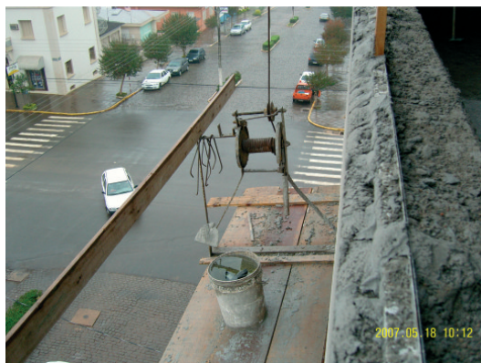
Figura 3: Estado precário do andaime
