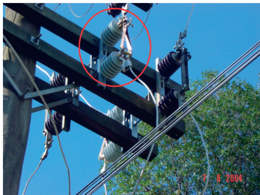
Figura 2: Chaves-faca, lados fonte e carga, encontradas pela Inspeção do Trabalho no dia 7/6/2004. No detalhe, o local da chave-faca central onde se deu o contato elétrico com o corpo da vítima
