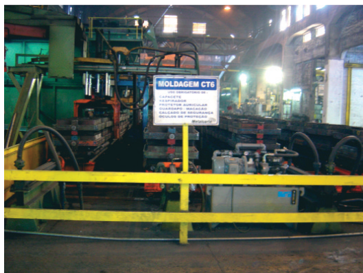
Figura 2: Vista frontal da linha de moldagem no dia 8/3/2005. Perímetro desguarnecido de proteção (barreira física ou equipamentos eletrosensitivos de segurança para detecção de aproximação de pessoas)
