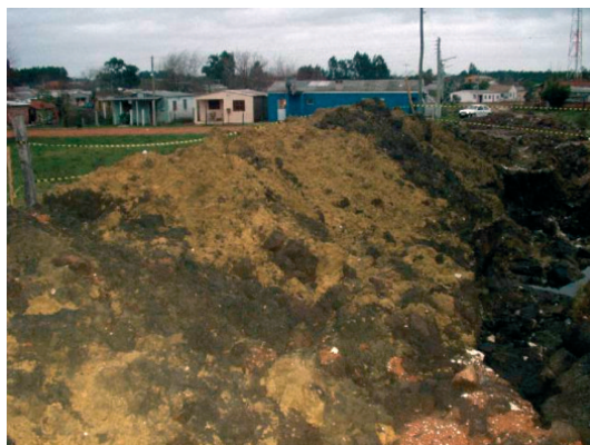
Figura 2: Detalhe da vala onde ocorreu o acidente
