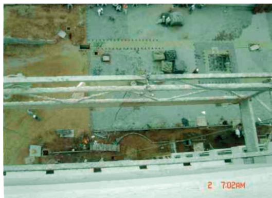
Figura 3: Verificava-se também que os suportes do piso do andaime do lado mais próximo do edifício, os quais são fixados na estrutura principal do andaime, estavam virados para o lado externo do equipamento
