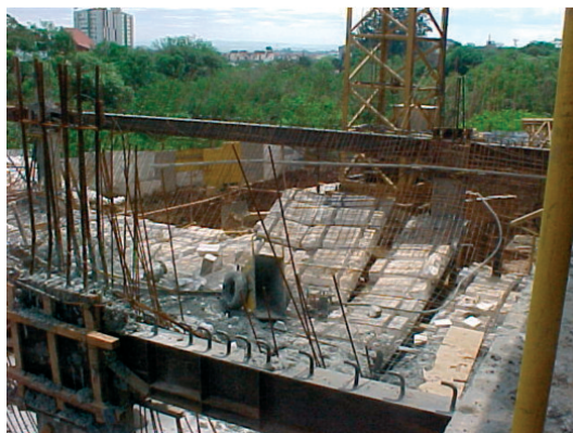
Figura 2: Detalhe do local do acidente
