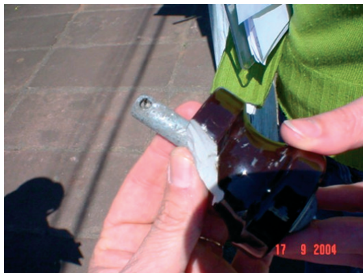
Figura 3: Visão do isolador de porcelana, tipo castanha, quebrado, com oxidação de elementos, indicando estar há algum tempo neste estado. Informação prestada por assessoria da empresa contratante, hipótese reforçada pelo encontro de pedaço da castanha no chão, parcialmente coberto por terra. Foto colhida e cedida pela empresa
