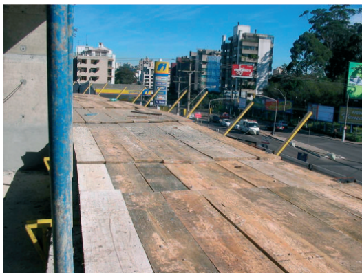
Figura 1: Plataforma de proteção
