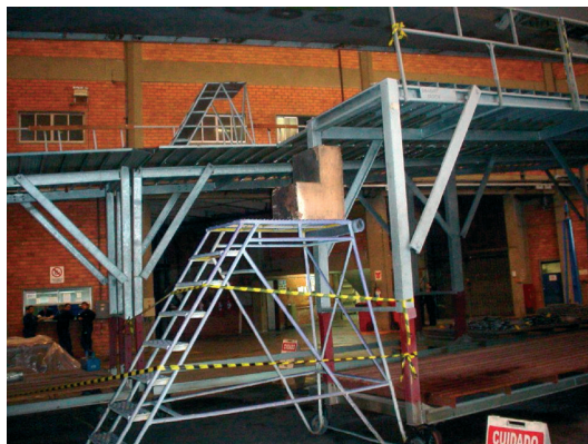
Figura 2: Reconstituição do meio de acesso à doca modular utilizado no dia do acidente. Observe-se a ausência do módulo da doca correspondente à escada e às improvisações utilizadas
