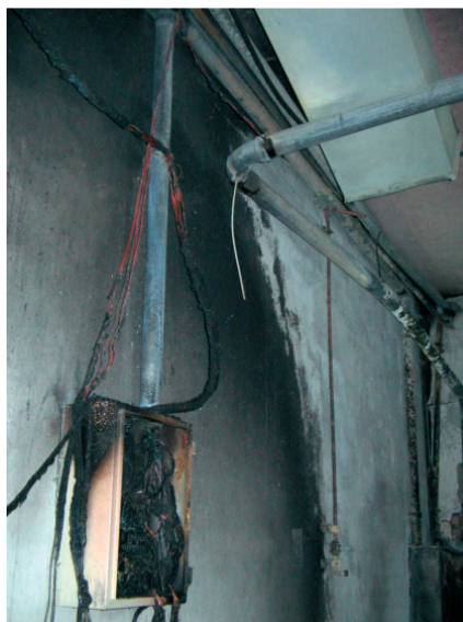
Figura 6: Detalhe do quadro elétrico
