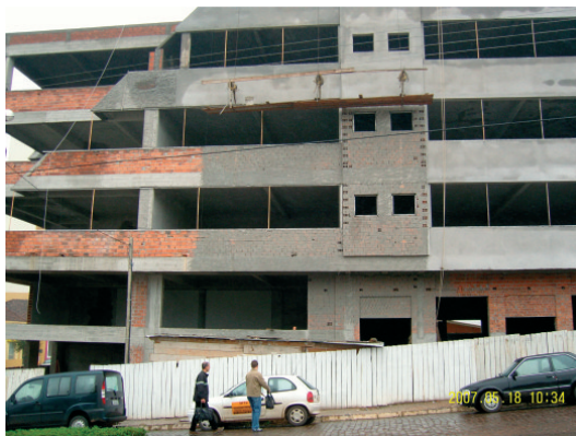
Figura 1: Vista frontal do prédio em construção, mostrando o andaime suspenso mecânico, onde ocorreu o acidente
