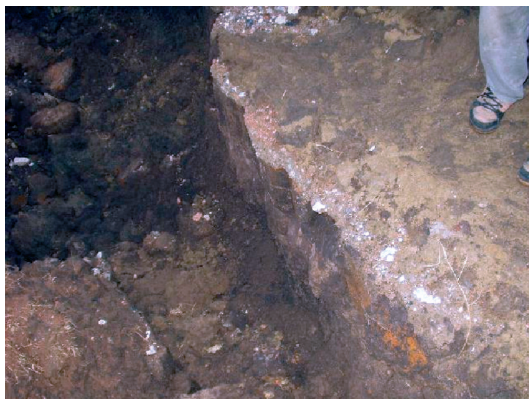
Figura 5: Detalhe do local do acidente
