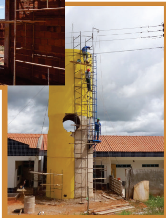
Exemplos de situações de risco de queda de trabalhadores e projeção de materiais em obras de todo o país. Os casos, frequentemente apurados nas obras do país, apresentam andaimes e instalações completamente inseguros e inexistência de proteções coletivas nos locais de trabalho. Fotos registradas por Auditores Fiscais do Trabalho em diferentes estados e regiões do Brasil entre 2012 e 2015
