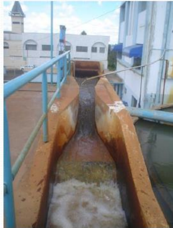
Calha Parshall ETA1 Bebedouro (SAAEB)
