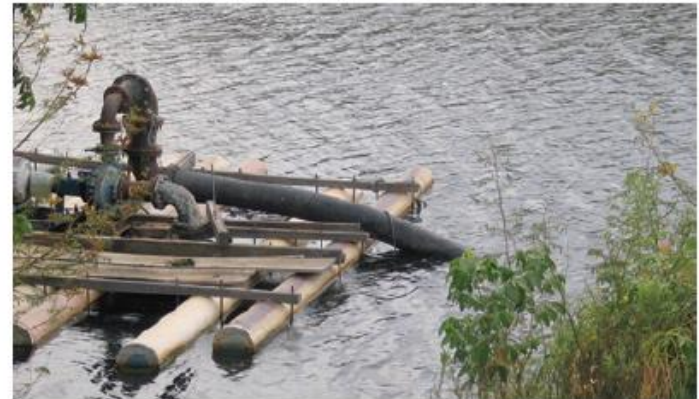
Figura 3 – Estrutura para captação a fio d'água em curso d'água superficial. Foto: Paulo Spolidorio / Banco de Imagens da ANA.
