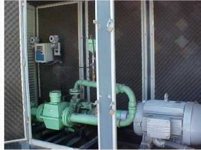
Booster com inversor de frequência instalado no Portal D'Oeste, RMSP
