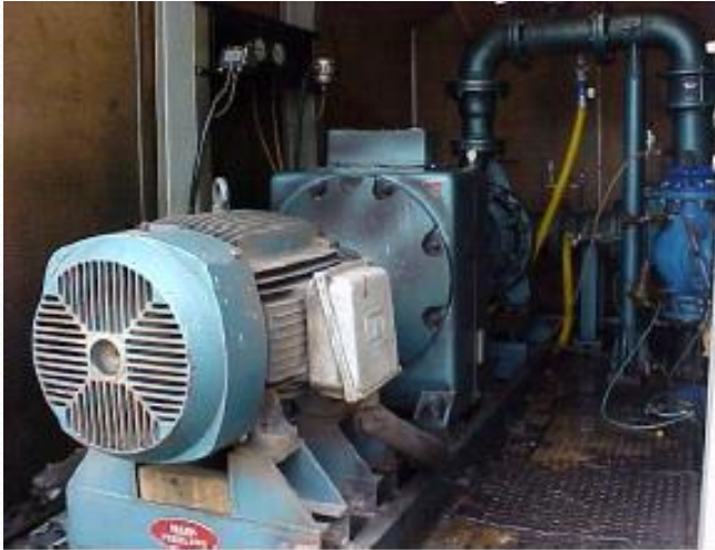
Booster com variador hidrocínético instalado na Conceição, RMSP.
