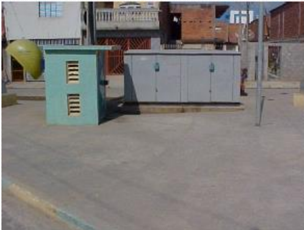
Instalações do booster Vitápolis com inversor de frequência, RMSP
