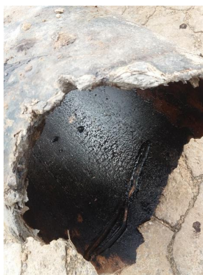
Figura 6 - Deposição de manganês em adutora de água tratada (Arquivo Pessoal)
