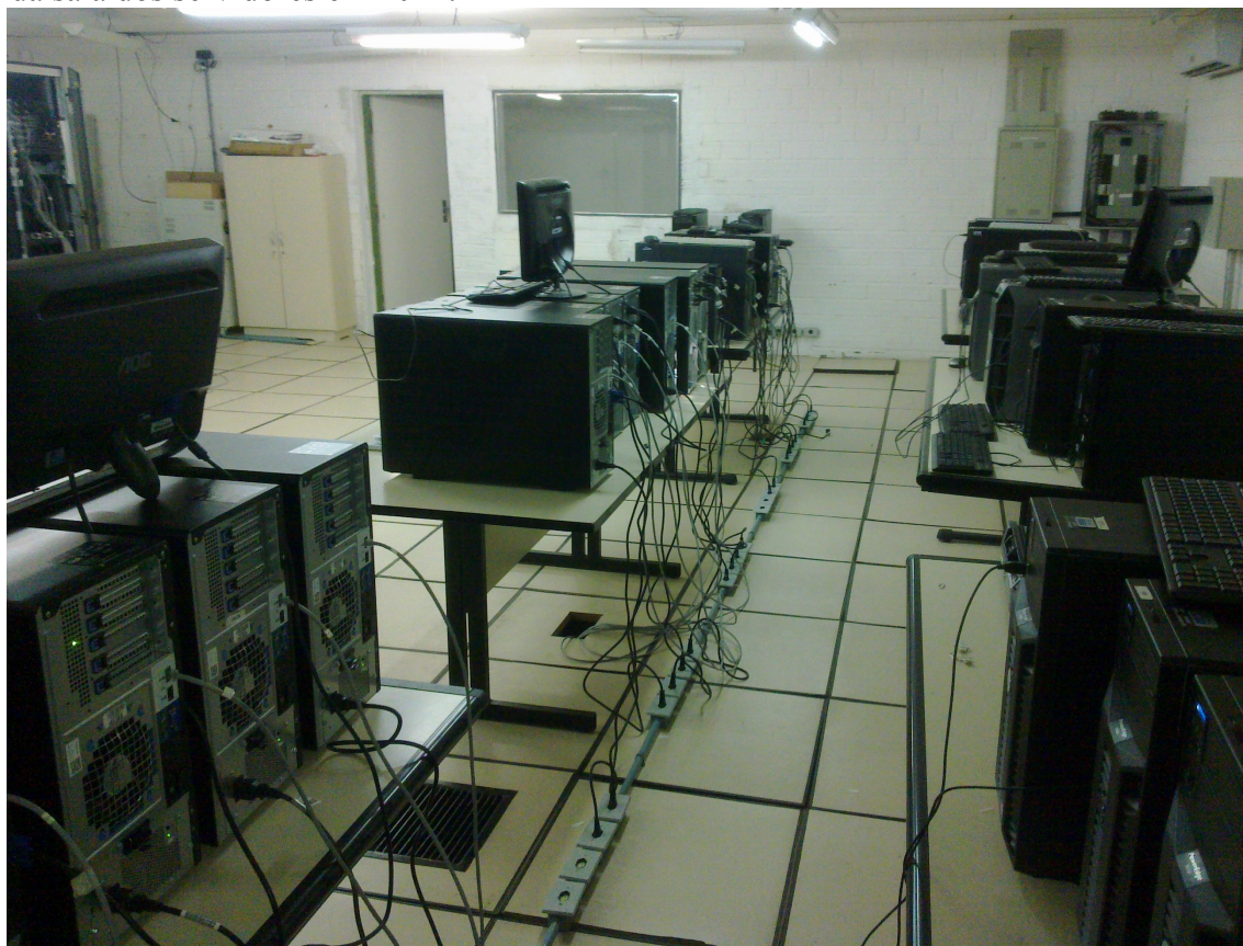
Fotos da sala dos servidores em 2012.
