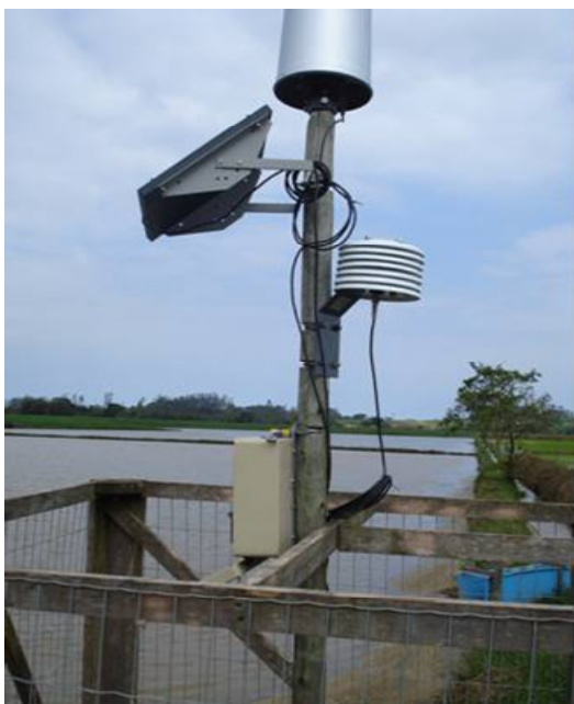
Figura 20: Estação automática instalada em Ermo.
