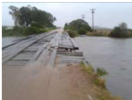
Figura 4. Estrada Costa Doce com bueiros de tubos de concreto danificados e recapagem de compactação do solo danificado, além de valos de drenagem pluvial entupidos em uma extensão de 10 quilômetros e ponte danificada.
