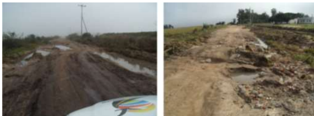
Figura 3. Estrada da Coxilha Grande com cinco bueiros de canos de concreto armado rompidos, recapagem de compactação do solo danificado e valos de escoamento pluvial entupidos em uma extensão de dezoito quilômetros.
