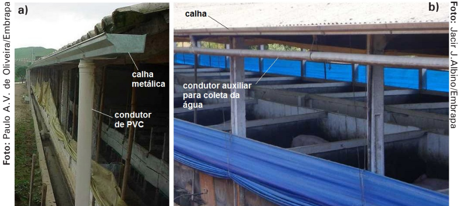
Figura 4. Exemplos de calha coletora e condutor auxiliar em telhados de granjas
