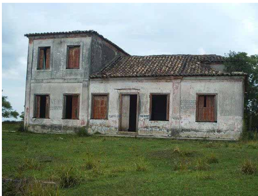
Figura 19 - Edifício situado no primeiro sítio urbano. Foto do autor. Pertenceu ao Barão de Butuy (José Antônio Moreira). A depredação e atos de vandalismo e até mesmo roubo de materiais são constantes, pois não existe fiscalização. A foto de fevereiro de 2005. Podem ser observadas as duas fotos, esta, comparada com a anterior (figura 18), que foi extraída em 2005, dá para constatar o descaso com o patrimônio.
