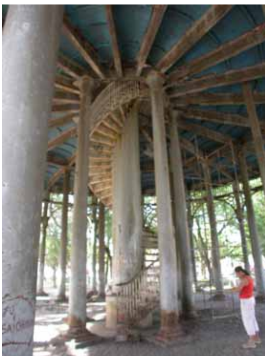
Ilustração 94 – Escada helicoidal do Reservatório da Praça Piratinino de Almeida.
