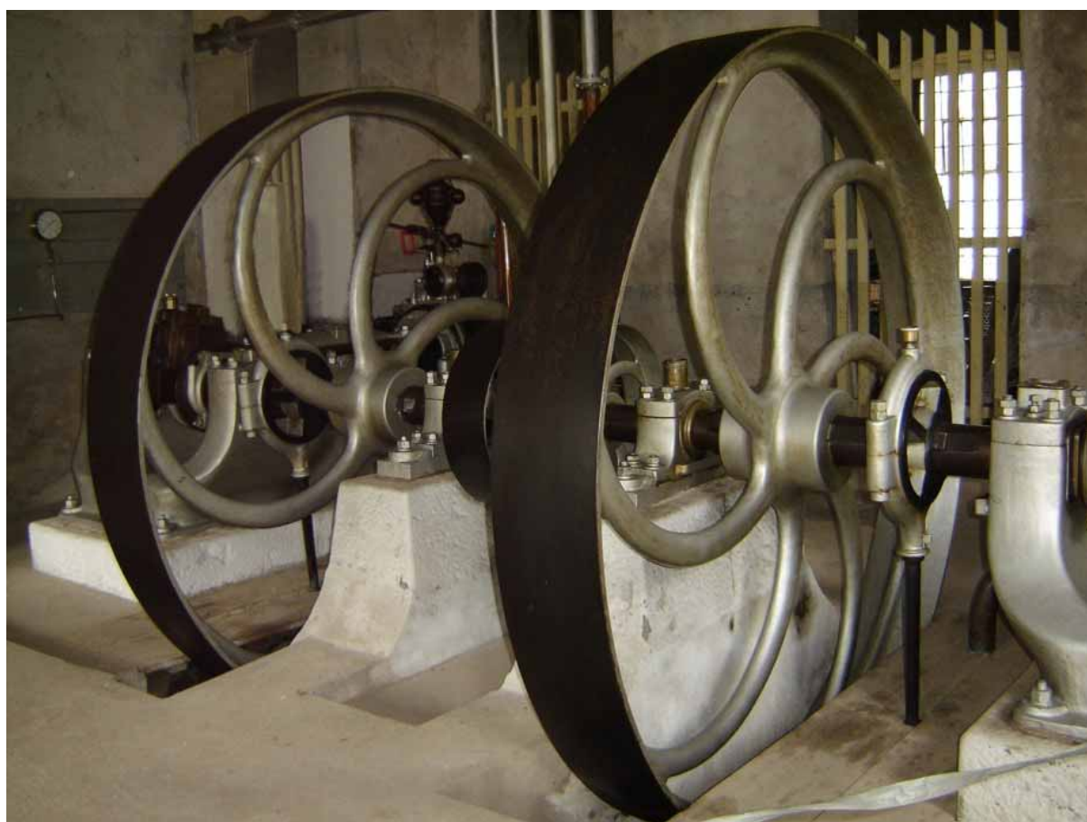
Ilustração 26 – Máquinas a vapor da Estação de Tratamento de Água do Moreira, Pelotas, RS. Fonte: Foto da autora, 2006
